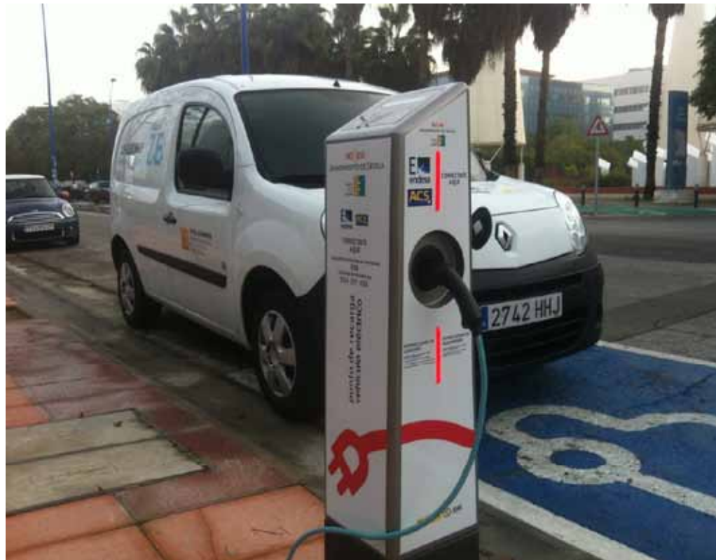
Ejemplo de punto de recarga. Estación de acceso público
