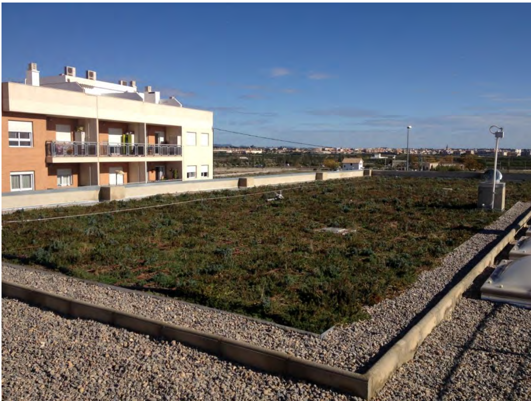
Figura 6.13 Cubierta vegetada en Benaguasil (Valencia). Fuente: Green Blue Management (Grupo TYPESA).
