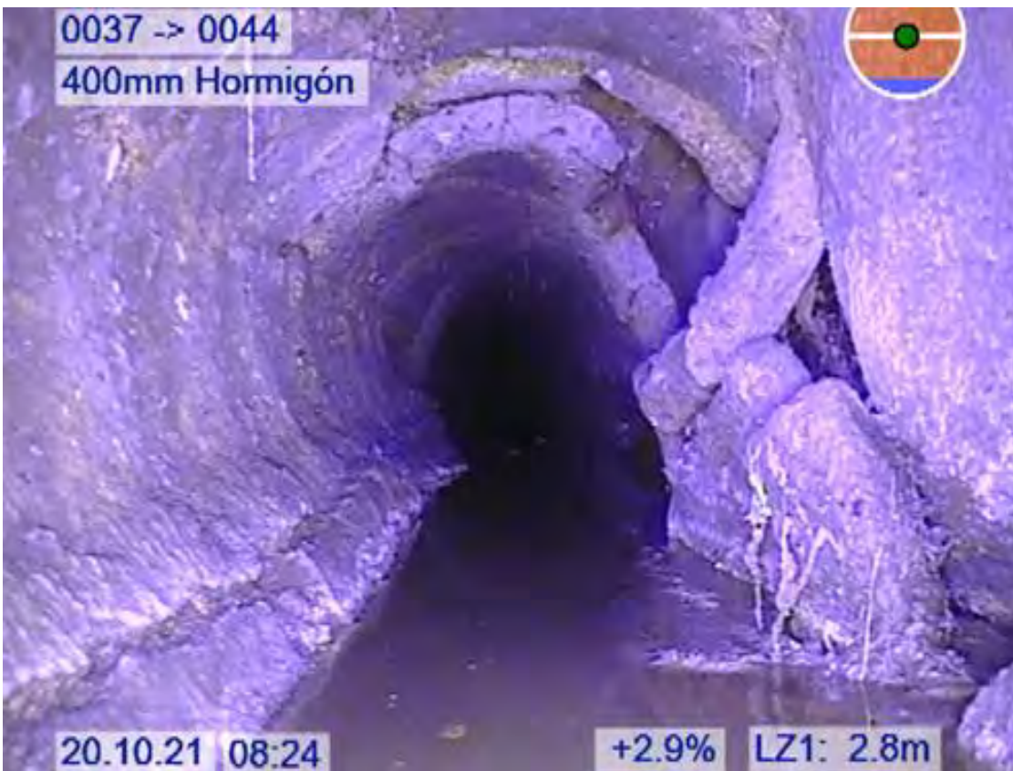
Figura 6.2 Defecto estructural de nivel 5. Fuente: Consorci Besòs Tordera
