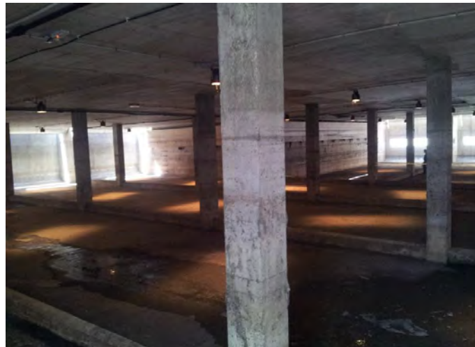
Figura 1.25.-Tanque de tormentas de Pozuelo. Fuente: Canal de Isabel II SA,MP.
