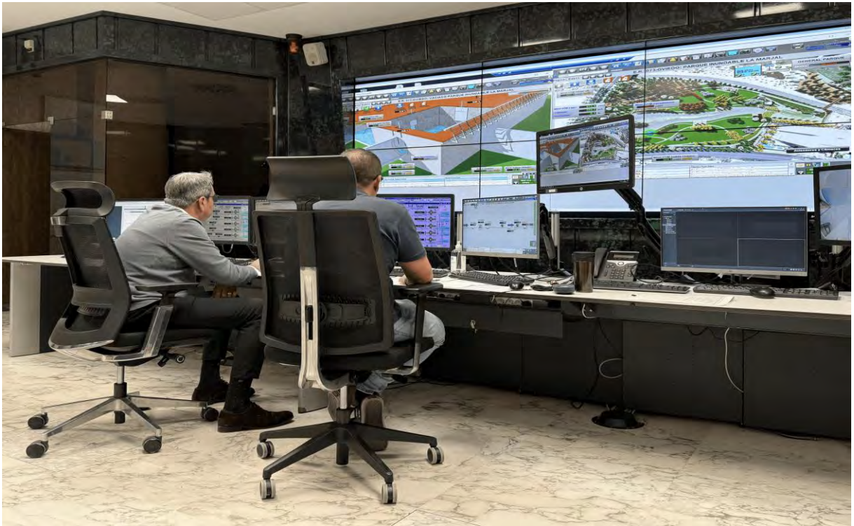
Figura 6.10: Centro de control en tiempo real del saneamiento de Alicante.
