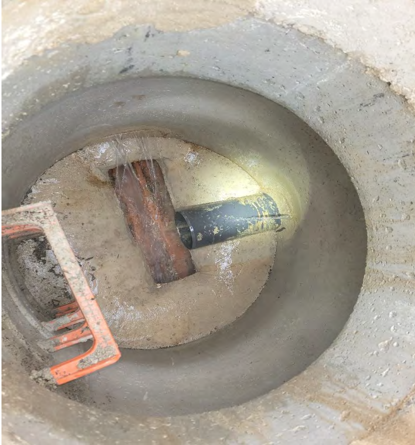
Figura 6.11 Infiltración en un pozo de registro (aguas parásitas). Fuente: Hidrostantk
