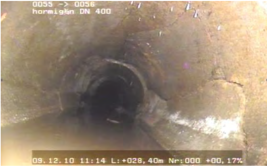
Figura 6.1 Defecto estructural de nivel 4. Fuente: Consorci Besòs Tordera
